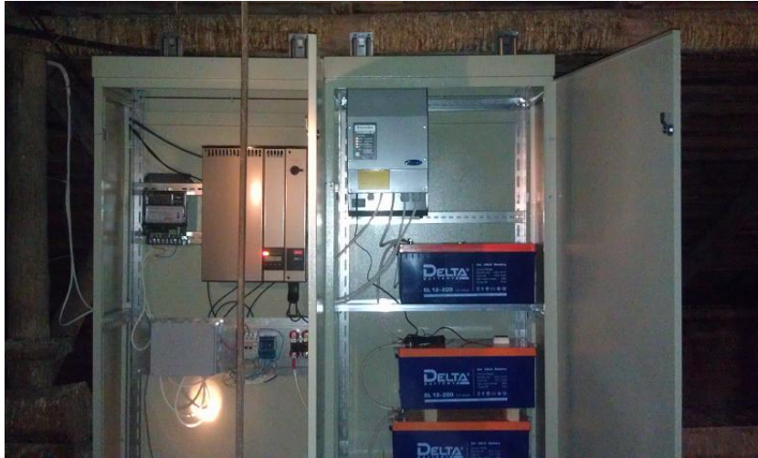
Рис.3 Шкаф с инверторами и аккумуляторами
