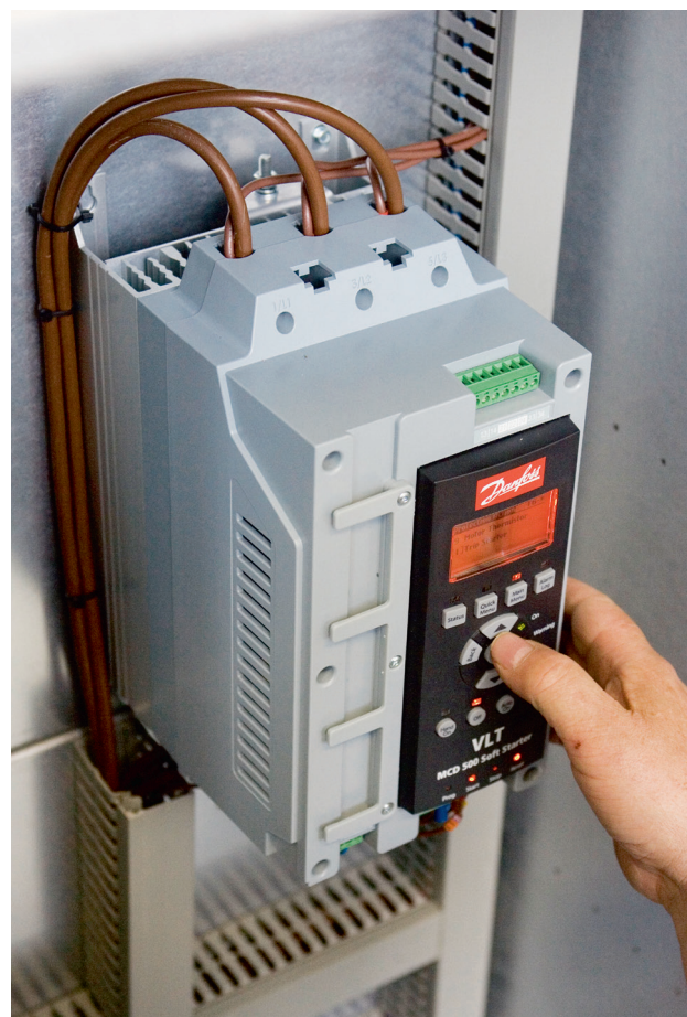
Рис. 3. УПП MCD 500 в шкафу управления
