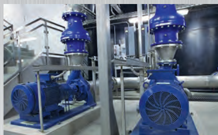
Станция водоснабжения в г. Вертхайм, Германия
