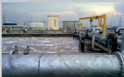
Завод по очистке сточных вод, Ханой, Вьетнам
