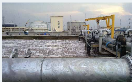
Очистка сточных вод, Ханой, Вьетнам Установка очистки сточных вод, Yen So Park, обрабатывает 50% сточных вод города. На ней установлено свыше 90 ПЧ, из которых 12 приводов VLT® AQUA Drives 450 кВт контролируют работу воздуходувок.
