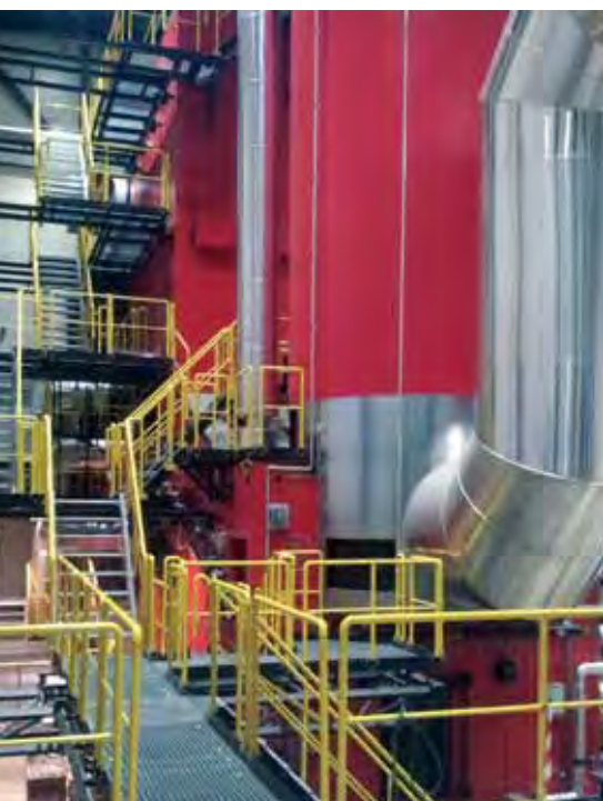
Вертикальный котел биотоплива и жидких отработанных газов
