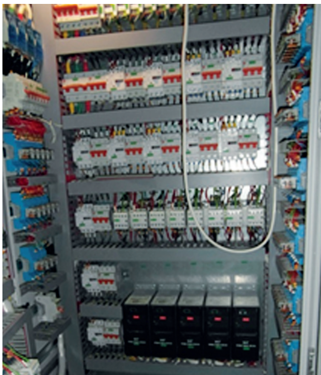
Многосекционный комплектный шкаф индивидуального изготовления для энергообеспечения, автоматизации и мониторинга технологического оборудования с применением преобразователей частоты Danfoss.
