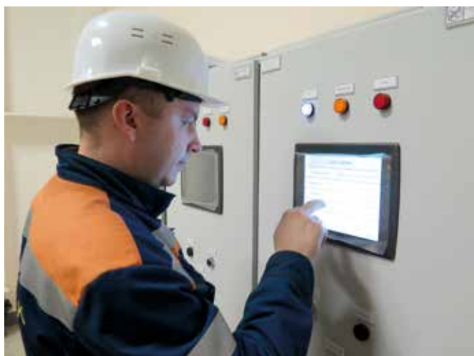
Пост местного управления системы бесперебойного питания
