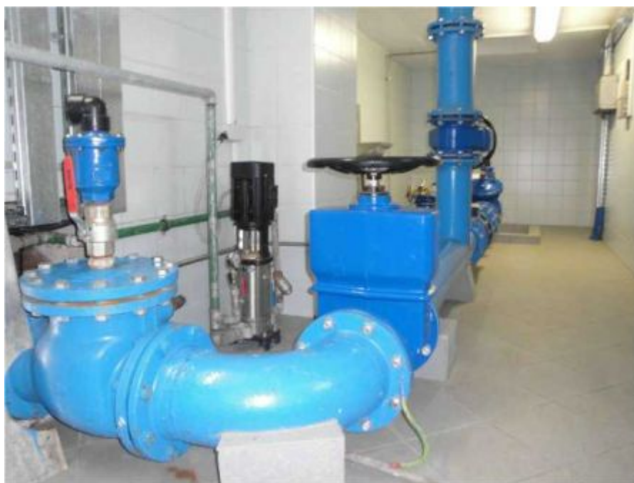
Погружной насос на станции центрального водоснабжения Любляны
