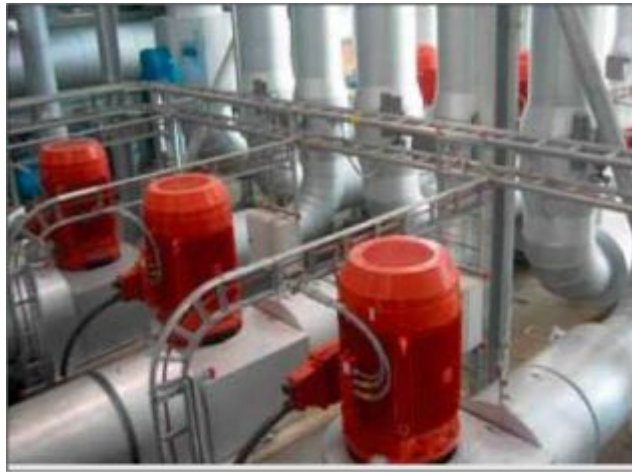
Водяные насосы 6 x 355 кВт
