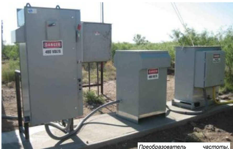
Преобразователь частоты, фильтр подавления гармоник и повышающий трансформатор
