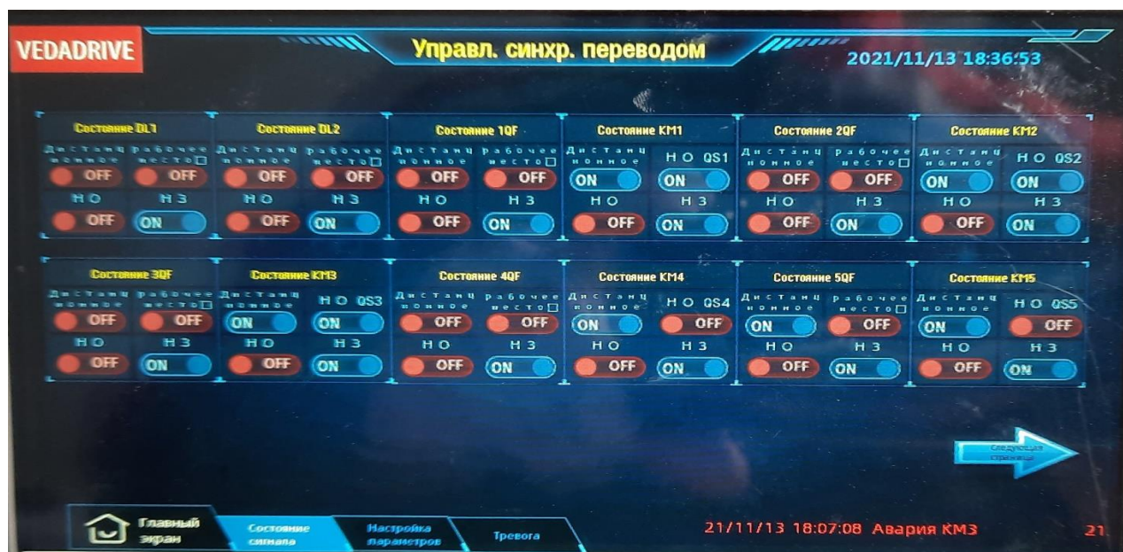
Рис. 6.14 – Окно состояния сигналов системы синхронизации с сетью
