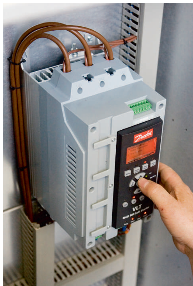
Рис. 3. УПП MCD 500 в шкафу управления
